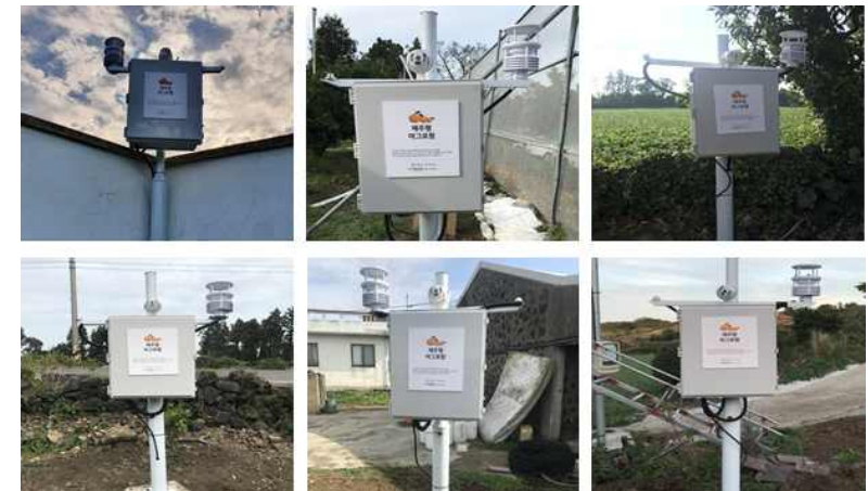
<제주지역에 설치된 자동기상관측장비(AWS) 현장사진>
